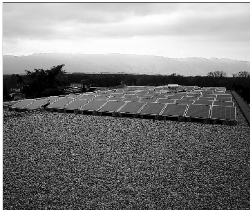
Les 140 m 2 de panneaux photovoltaïques. Le DL/V. B.
